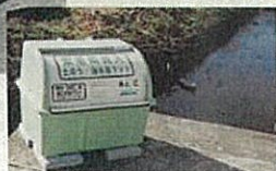
下流に緊急用具配備
